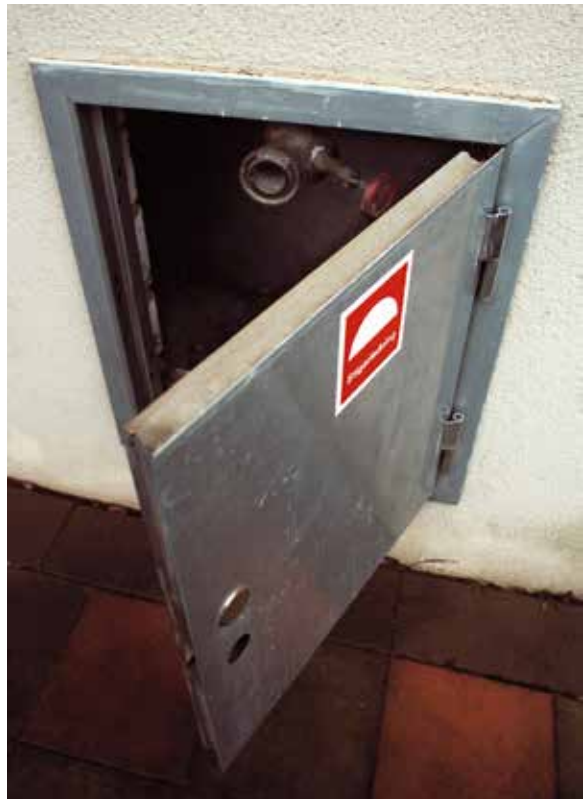
I stigarledningen i luckan på fasaden kan räddningstjänsten koppla in vatten. Inne i trapphuset finns sedan uttag där slangar kan anslutas.
